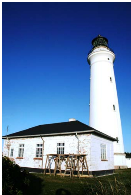
Maskinhuset er meget udsat, og det trængte alvorligt til en omgang maling.
